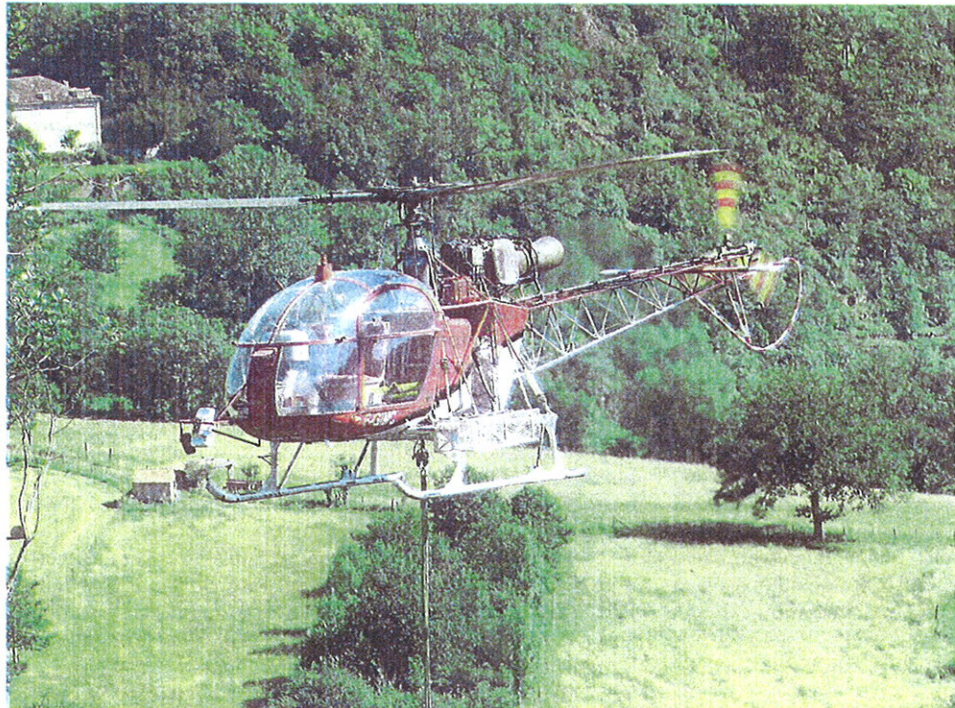
En certains endroits du chantier, il a été fait appel à des moyens techniques hors du commun, comme l'hélicoptère pour poser la nouvelle canalisation. / Photo DDM archives
